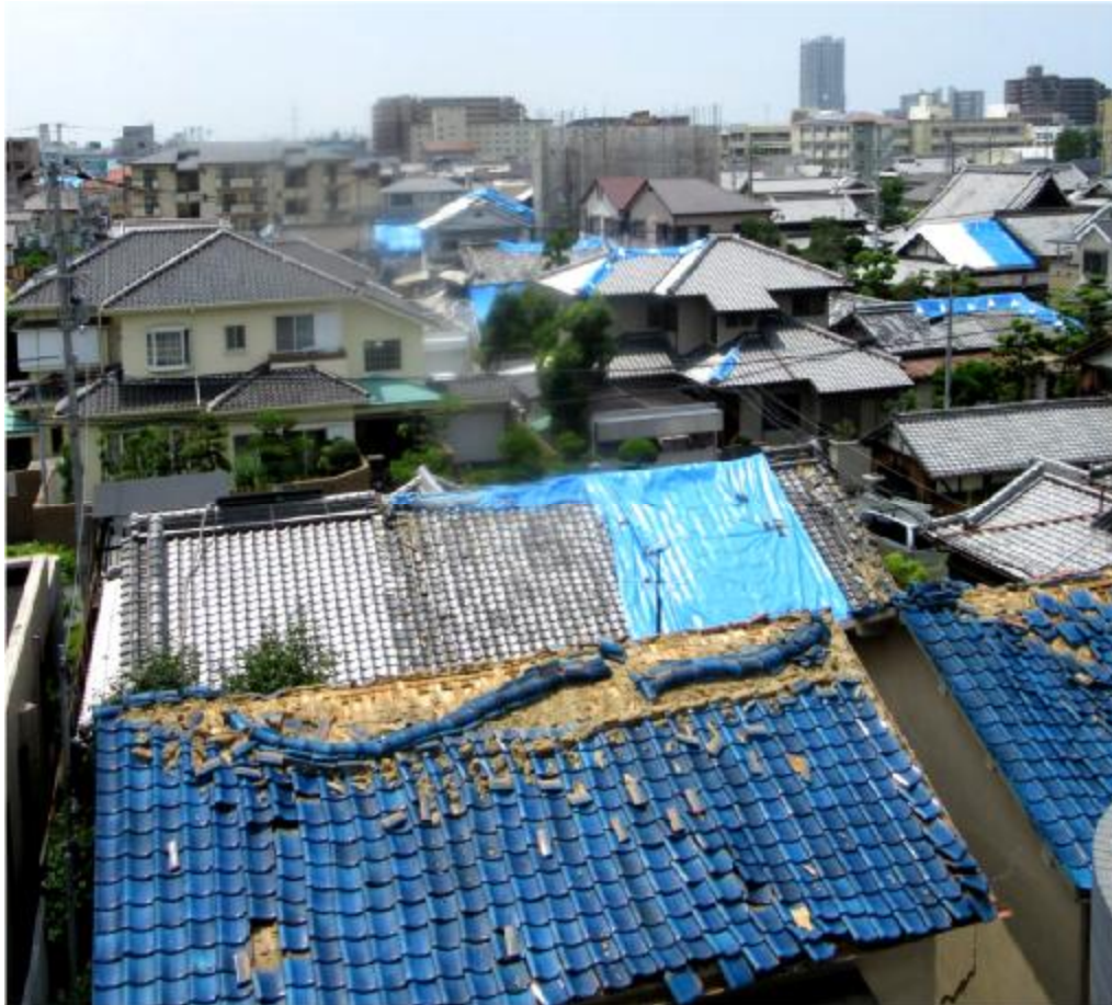
屋根瓦に被害があった住宅 （高槻市）
