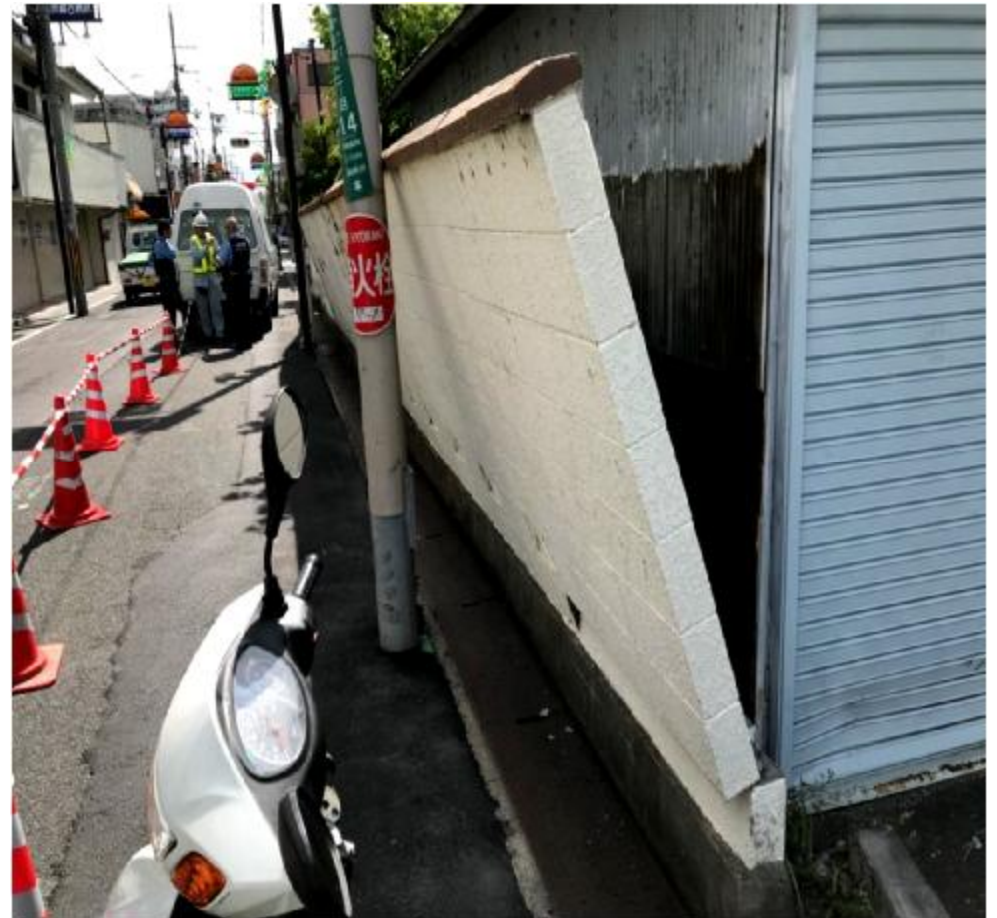
転倒したブロック塀 （高槻市）
