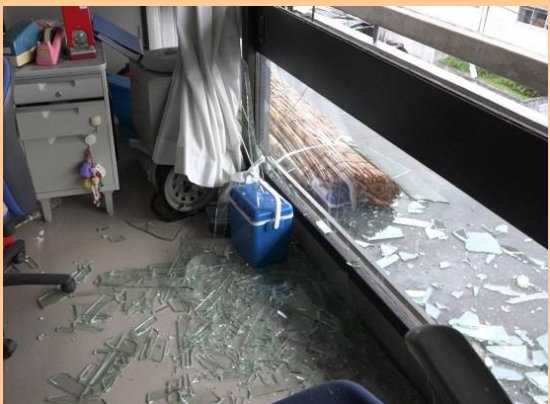
非構造部材のガラスが割れる （鳥取中部地震・倉吉市役所）
